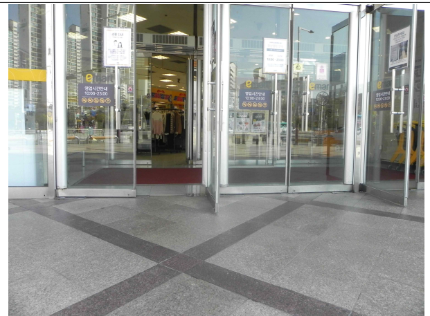
점자유도블록이 설치 되지 않은 출입구
