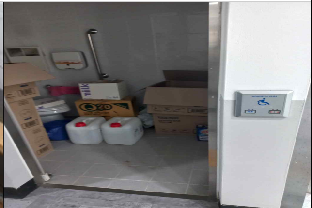
장애인용 화장실을 창고로 사용중인 문화원
