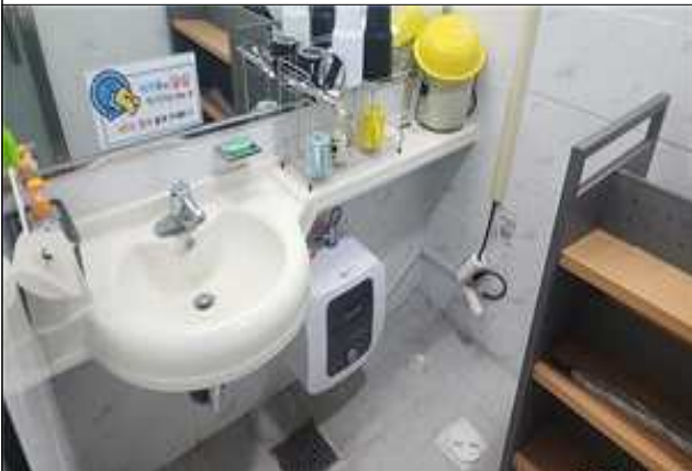
다른용도로 사용중이며, 회전도 어려운 공연장의 장애인용 화장실
